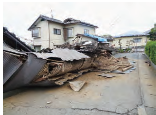
木造建物の倒壊
