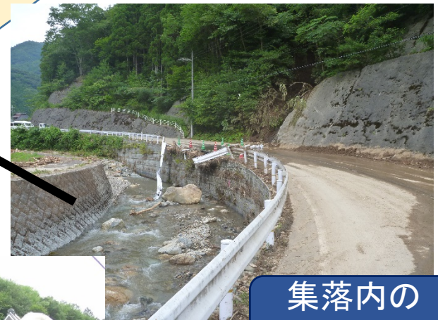
自宅裏山が 崩壊
