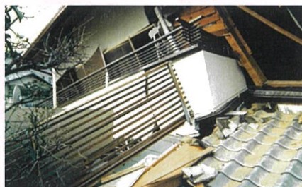
倒壊した自宅の2階部分 (0000625-001-001.005)
