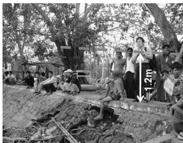
写真-2 ヤンゴン・フェリー乗り場 (N16 度 46 分 3.53 秒、E96 度 09 分 48.54 秒) ヤンゴン市内の船の渡し場では、護岸を 1.2 m 超える高潮が押し寄せた。
