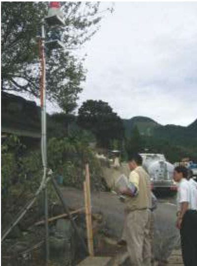
参考写真24 土石流検知警告サイレン および回転灯【d】
