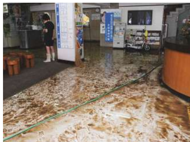
参考写真10 浸水後の市役所1階状況【c】
