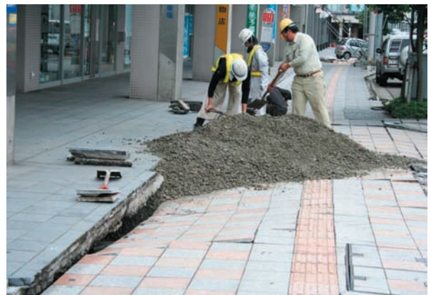
写真2 道路と建物の間にできた段差
