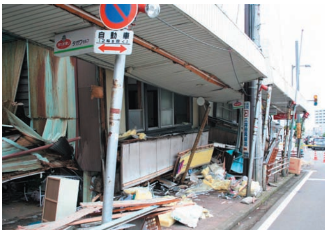
写真6 柏崎市東本町の商店街の被災状況
