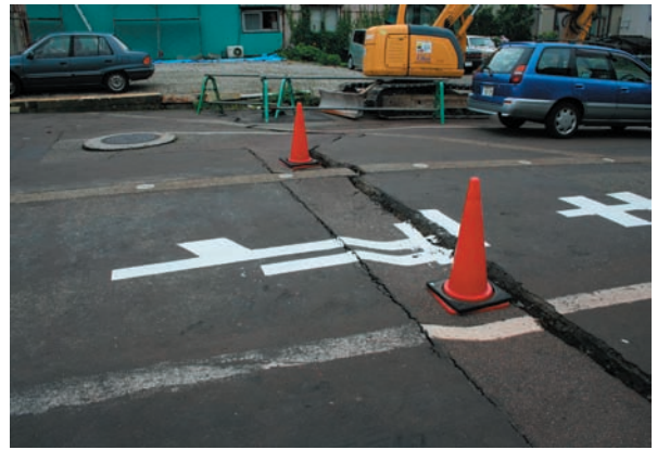
写真1 道路にできた段差
