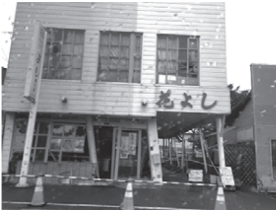
写真 5-1 損傷した建物(09.13 撮影)
