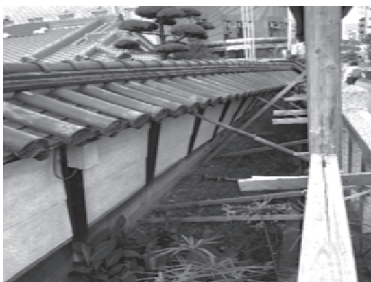
写真 3-14 倒れた神社の塀(06.25 撮影)
