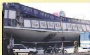
1/17阪急伊丹駅の被災状況 0000420-001001-001.00008
