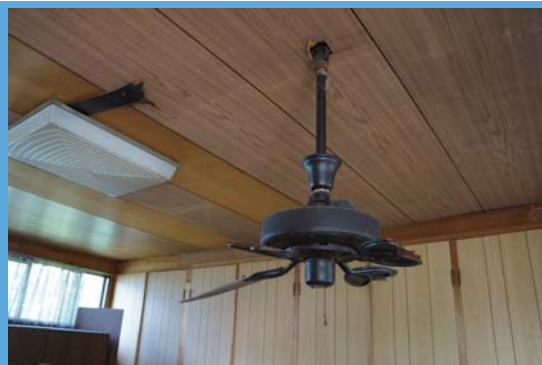
谷口さん宅の天井扇。羽の1つが天井と室内灯の間に挟まっている。
