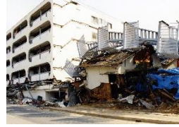
No.5982 マンションの被災状況 神戸市東灘区 1995/4/2
