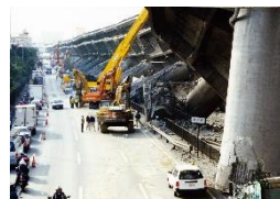
No.5998 横倒しの阪神高速道路 神戸市東灘区 1995/1/19
