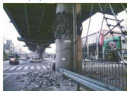
No.5996 阪神高速道路橋脚 神戸市長田区 1995/1/17
