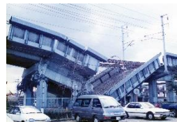
No.6002 新幹線高架崩壊 西宮市 1995/1/24
