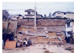
No.5997 崩壊した路肩 神戸市須磨区 1995/1/17
