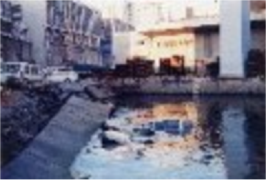
No.6049 港湾の被害 神戸市中央区 1995/2/19
