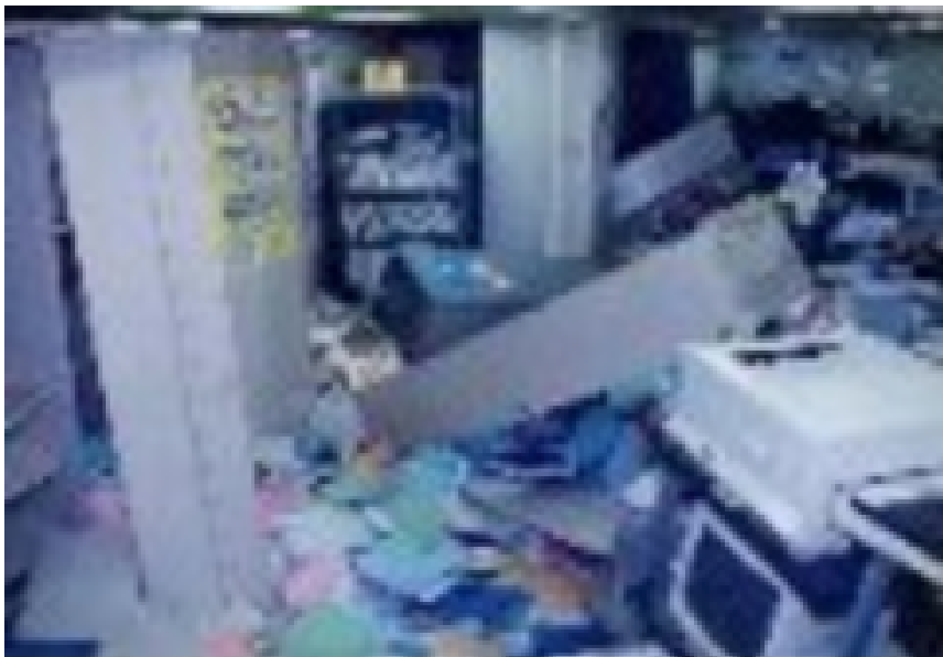
No.6040 県庁議会図書室の 被災状況 神戸市中央区 1995/1/17
