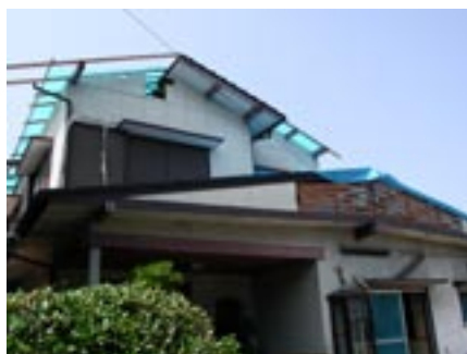
写真7 被災住宅（屋根損壊）
