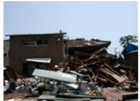
写真15 倒壊した倉庫
