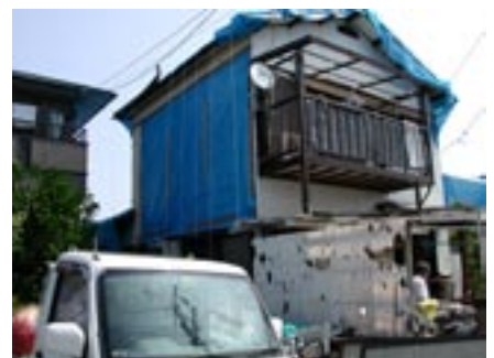
写真8 被災住宅（屋根、壁損壊）
