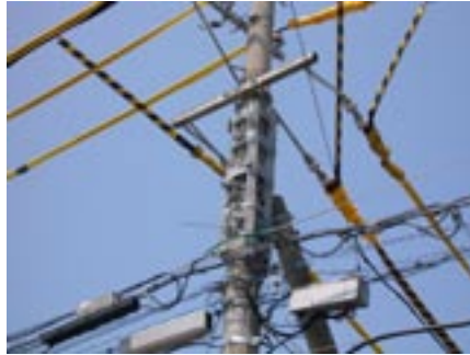
写真10 仮復旧した折れた電柱
