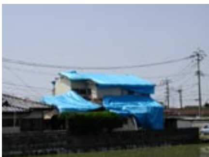
写真6 被災住宅（屋根損壊）
