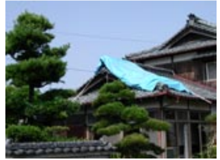
写真3 屋根の一部損壊
