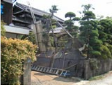
写真9 被災したガレージ
