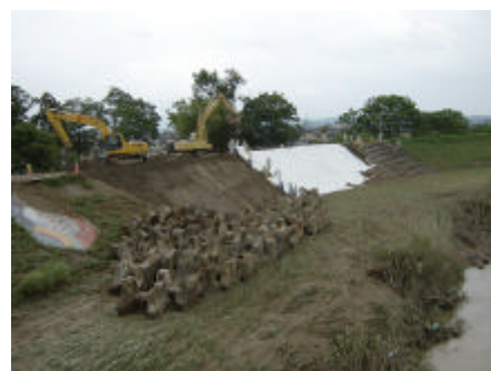
図-3 中之島町の刈谷田川決壊箇所
