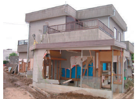
図-12 足羽川の堤防の決壊により被災した福井市春日地区の住宅
