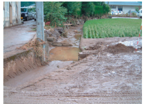
図-7 泥土により機能しなくなった排水溝
