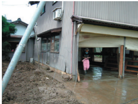
図-8 足羽川の破堤により被災した安波賀町地区の住居
