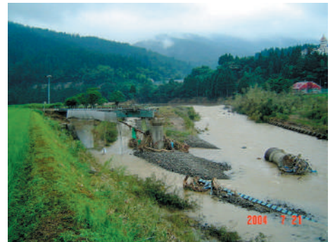
図-3 流失した JR 越美北線の鉄橋
