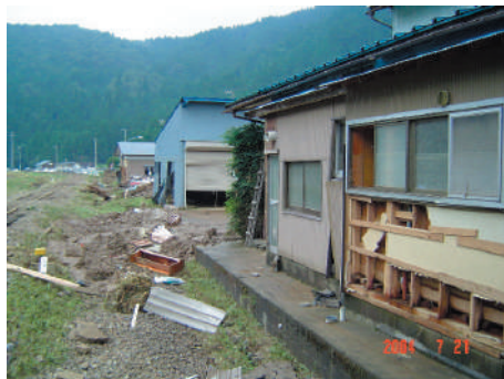
図-6 足羽川の溢水により被災した美山町の住居
