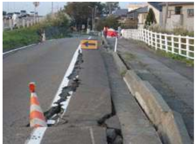
図-7 長岡市土合町国道17号被災状況
