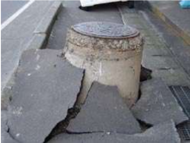
図-8 長岡市内の隆起した下水道のマンホール
