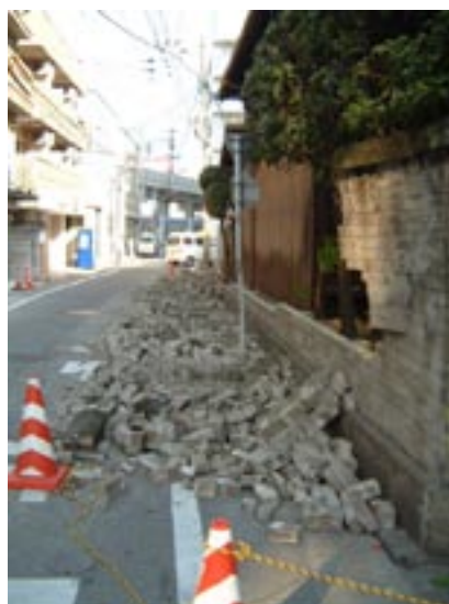
図5 福岡市中央区のブロック塀倒壊
