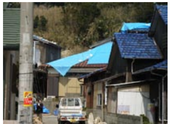
図7 西区西浦地区の被災状況
