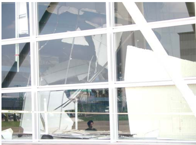
図5 スポパーク松森の天井崩落現場
