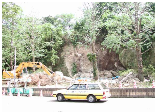
図6 市民プール前の土砂崩れ現場
