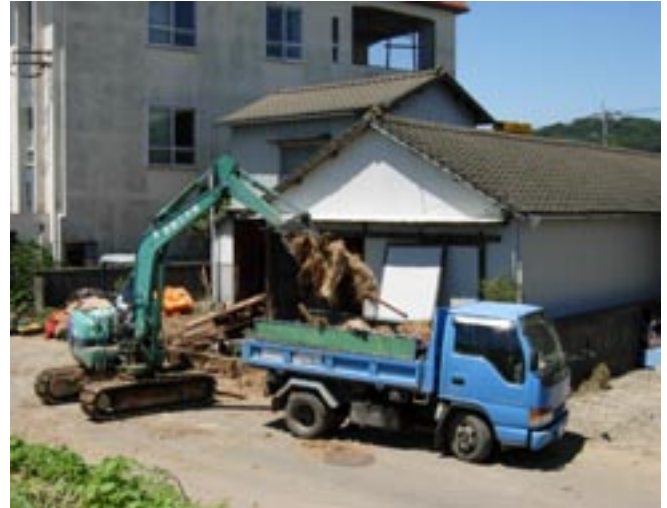
写真10 米ノ津川沿いの被災した家屋
