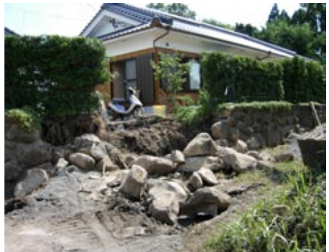
写真6 氾濫流により崩壊した石垣
