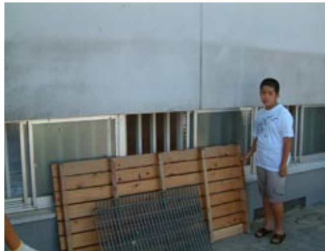
写真2 吉松小学校の体育館の壁に残る浸水痕
