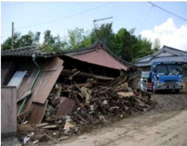
写真7 宮之城地区における被災した家屋
