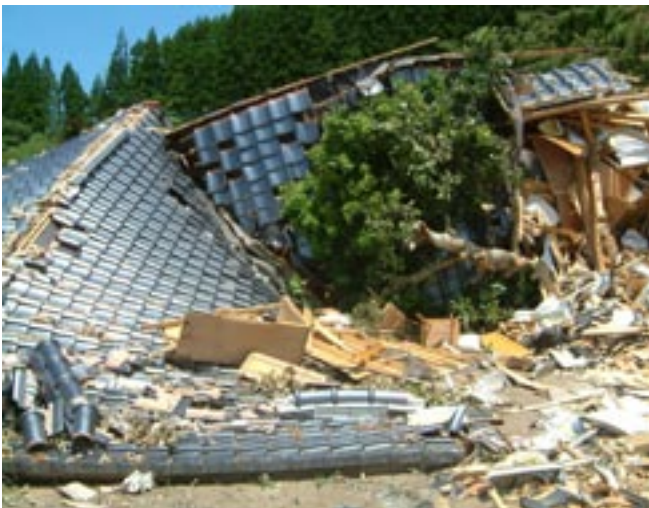
写真3 土砂崩れにより全壊した家屋
