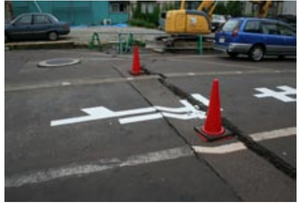
写真 1 道路にできた段差
