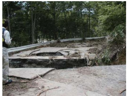
写真4 栗原市荒砥沢ダムそばの道路被害
