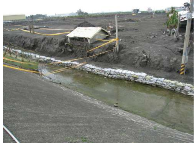
写真7 林辺郷河口部(下流側)の破堤地点の状況
