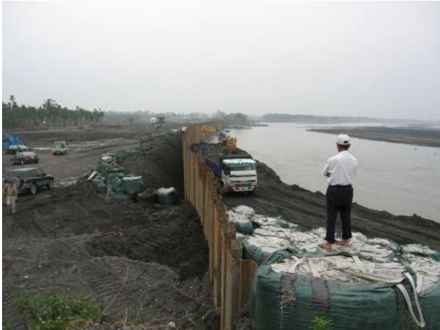
写真6 林辺郷河口部(上流側)の破堤地点の状況
