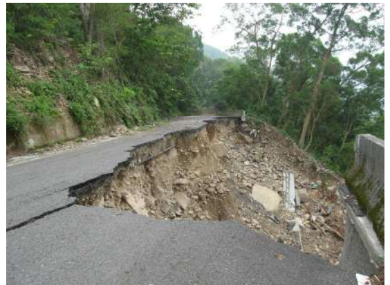
写真4 道路損壊の状況(三地門郷)
