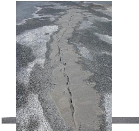
(写真1) 液状化による土砂・水の噴出 (淡路市役所駐車場)
