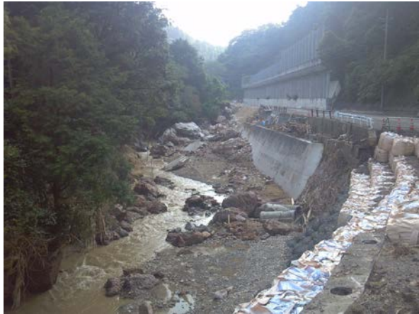
写真3 津和野町名賀白井周辺 (河川氾濫および土砂崩れにより路肩が崩壊している)
