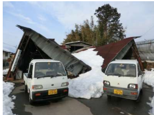
写真8 倒壊した出荷施設(笛吹市内)
