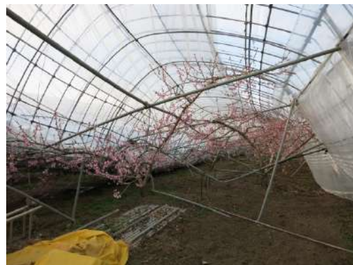
写真9 倒壊したビニールハウスの内部(笛吹市内)
