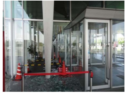
写真15 ガラス面の破損
