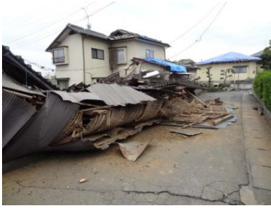
写真13 木造建物の倒壊
