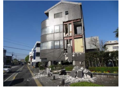
写真9 S造外壁の崩落
