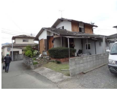
写真14 木造建物の損傷
