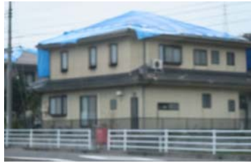
写真 20 屋根に張られたブルーシート
