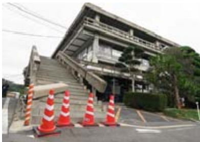
写真7 損壊した倉吉市役所
