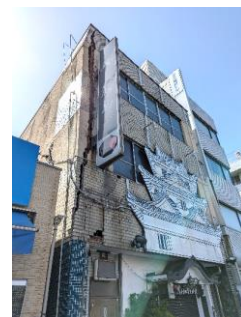
写真2 宇和島市内店舗の外壁の亀裂（4月19日）
