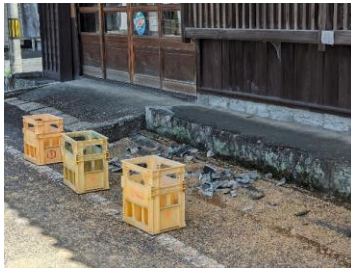
写真 8 宿毛市内の店舗から道路に落ちた屋根瓦 (4月19日)
