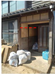
輪島市街の浸水被害 (点線の位置まで浸水)
