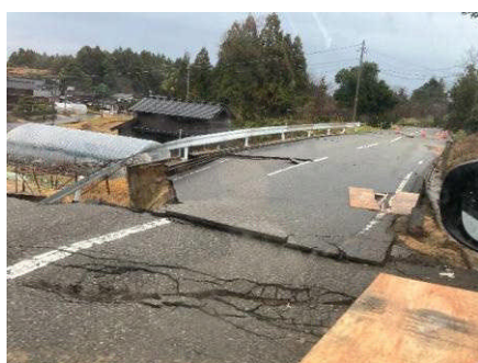
写真 3.3.1 寸断した道路 (穴水町)
